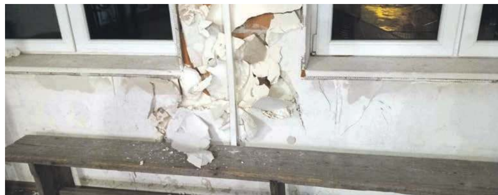
Zniszczona ściana w budynku klubowym Wolanki
