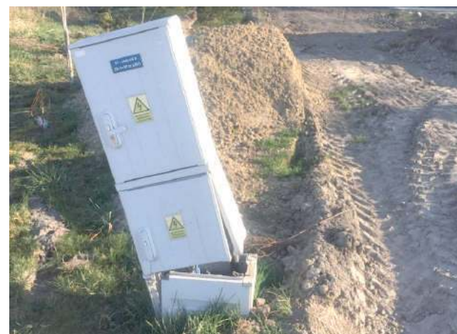
Pijany kierowca po kolizji ze skrzynką elektryczną zasnął w swoim aucie
