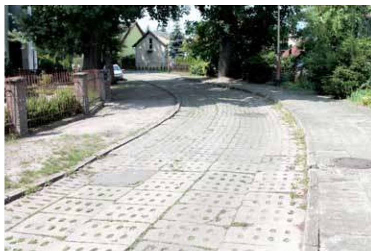
Na Alei Dębowej są jeszcze stare płyty jumbo. Droga jest słabo przejezdna
