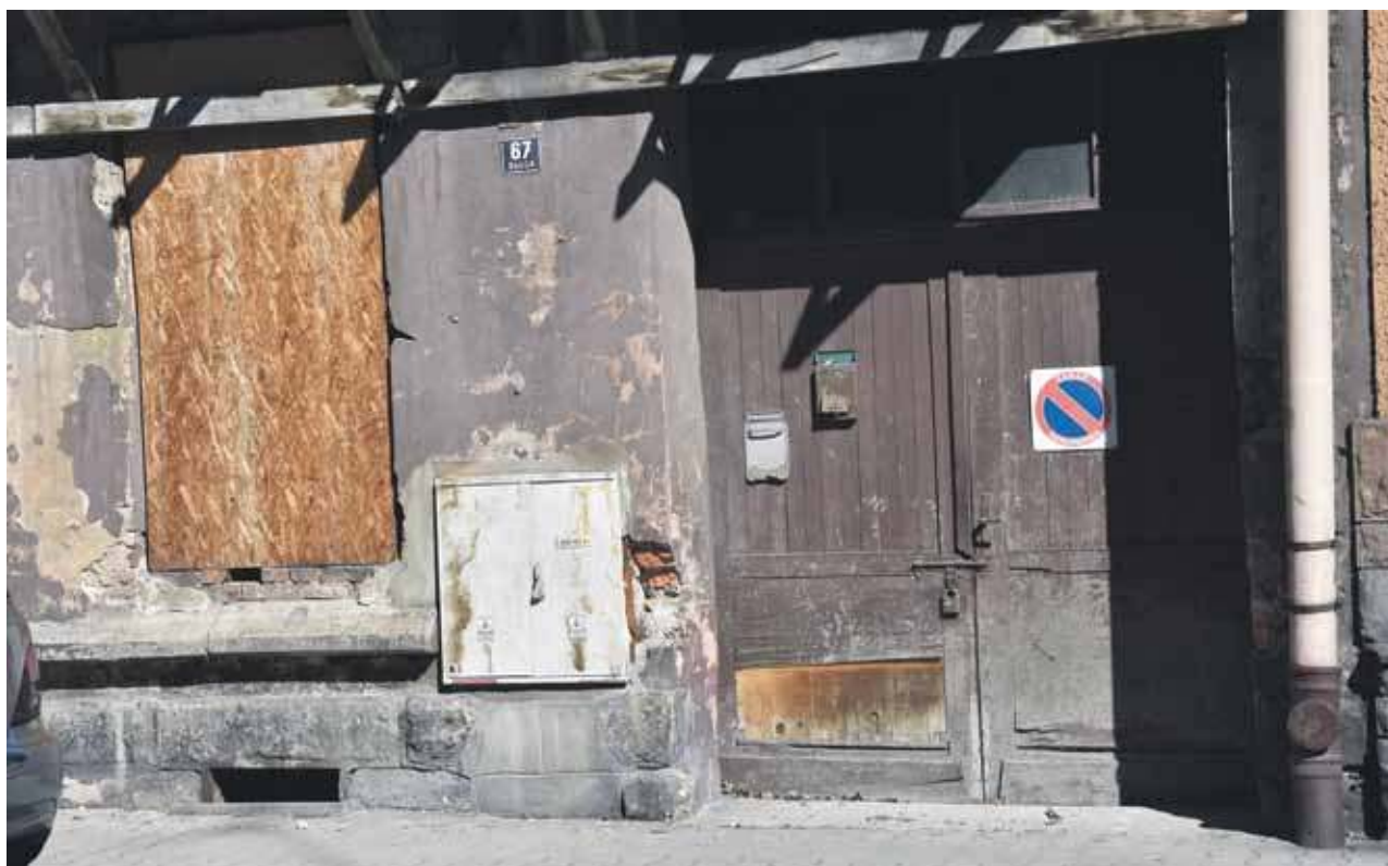
Zniszczona fasada kamienicy wyróżnia się na ul. Długiej.
