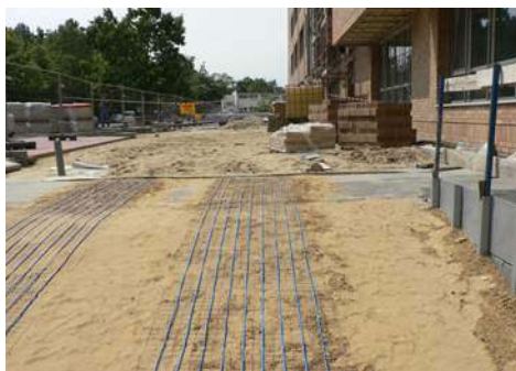
Na powierzchni płaskich podjazdów przewody grzewcze układa się zwykle w warstwie piasku pod kostką brukową. ELEKTRA
