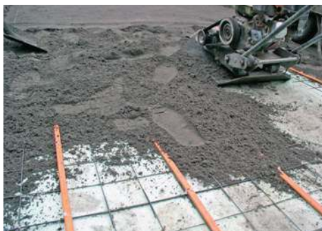
Na zjazdach i schodach najwygodniej jest założyć przewody w warstwie betonu. NVENT RAYCHEM
