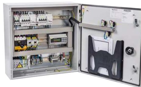
Działanie ogrzewania powinien nadzorować sterownik połączony z czujnikami temperatury oraz opadów. NVENT RAYCHEM
