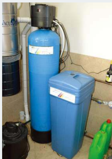
Stacja uzdatnia, filtruje i zmiękcza wodę ze studni głębinowej 30 m.
