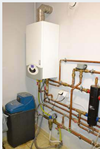
➋ Zmiękczacze umieszczono na rurze wodnej, za wodomierzem, przed kotłem grzewczym.
