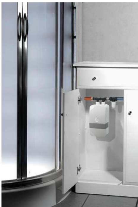
❗ Niewielki elektryczny podgrzewacz ciśnieniowy zamontowany w szafce podumywalkowej. DAFI (FORMASTER)
