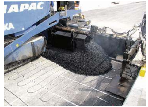
Droga na Lotnisko Chopina. System grzewczy nVent RAYCHEM EM2-MI.
