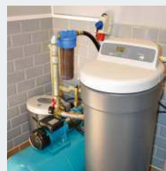
Sprzęt obsługujący automatyczne głowice.
