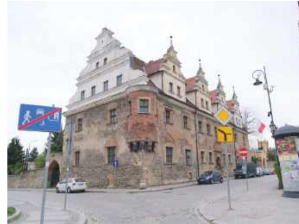
Dach Domu Książąt Brzeskich zostanie zabezpieczony siatką
