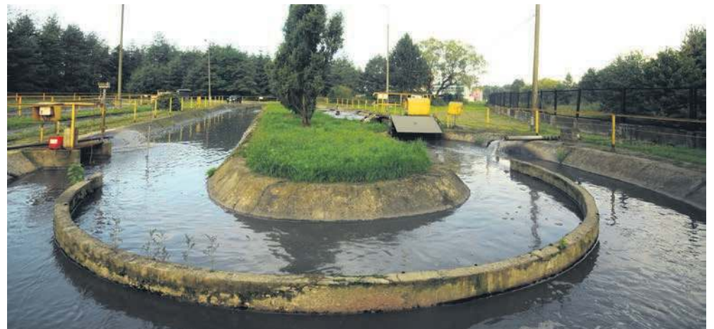
Dotychczasowa przepływowa oczyszczalnia ścieków w Alwerni. Takich obiektów już się nie buduje i raczej nie modernizuje.
