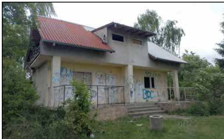
Trzy domki noclegowe znajdują się w opłakanym stanie i przeznaczone są do rozbioru
