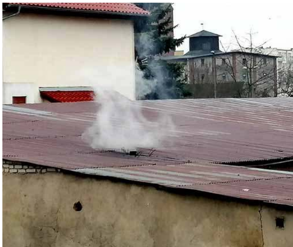
Tu, na dachu, był kiedyś komin, ale się spalił, od tej pory dym wydobywa się z jego pozostałości, niemal wprost spod blachy stanowiącej poszycie dachowe lokalu usługowego
