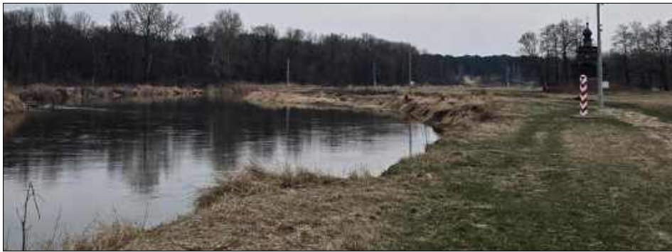
Przyczyną powstania wyrwy jest naturalna erozja brzegu rzeki Bug
