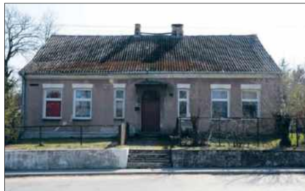
Na remont budynku przy ul. Podrzecznej w Łomazach mieszkańcy czekają od lat
