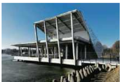
• Niszczący budynek w którym miała powstać restauracja na wodzie, inwestycja m.in. Roberta Lewandowskiego
