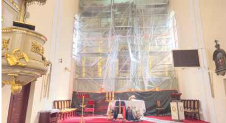
W kościele parafialnym pw. św. Filipa Neri w Kąkolewnicy trwa konserwacja i renowacja ołtarza głównego
