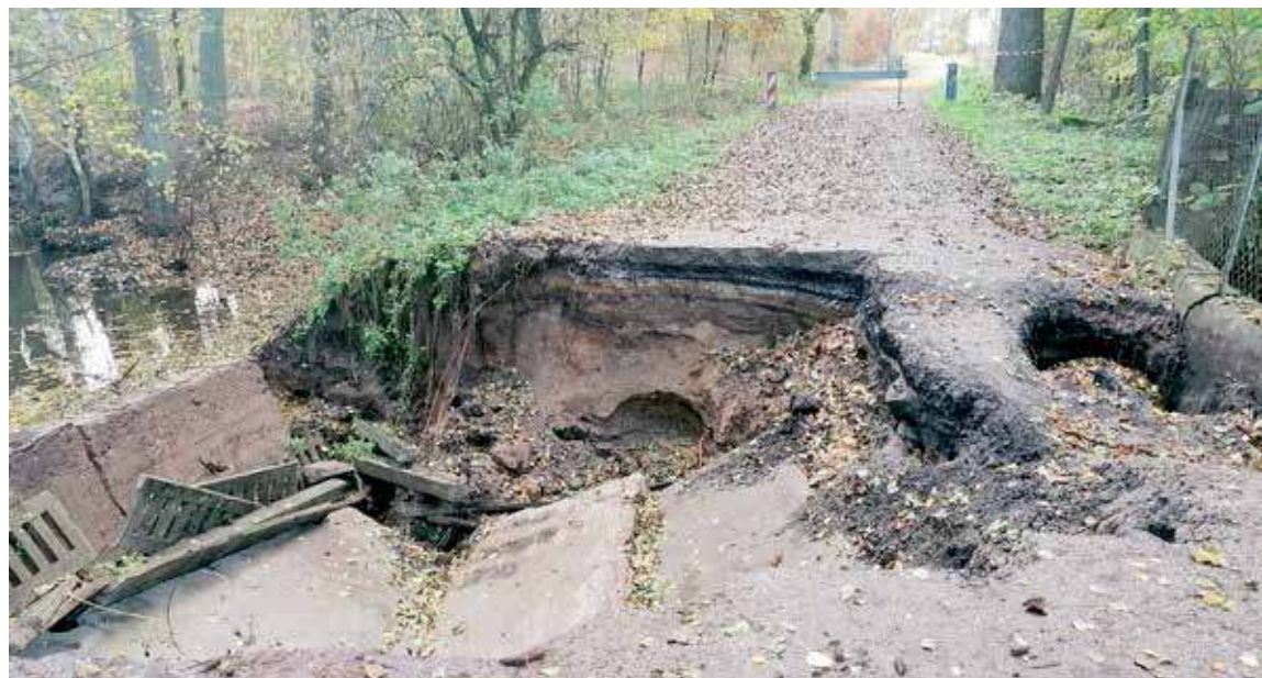
Olbrzymia wyrwa na drodze nie daje spać mieszkańcom Boguszyca od października 2020 roku
