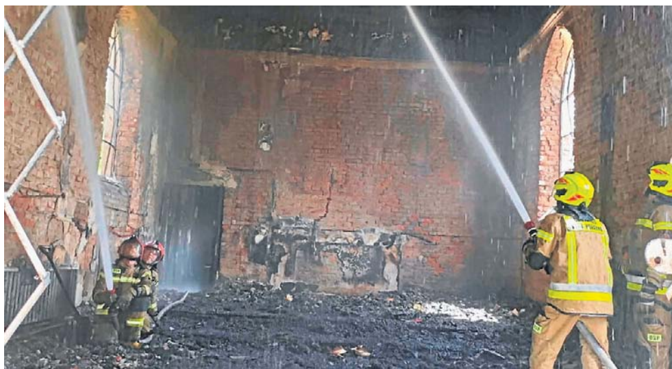
Kościół Matki Bożej Królowej Polski wybudowano w 1914 r. Płomienie zniszczyły wnętrze świątyni. Ołtarz, ławki, obrazy już nie nadają się do użytku
