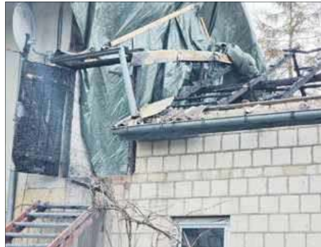
Pożar objął górną kondygnację budynku i doszczętnie strawił pomieszczenia strychowe oraz dach nad całym domem
