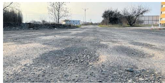
W obecnym stanie ulica przypomina tor przeszkód.
