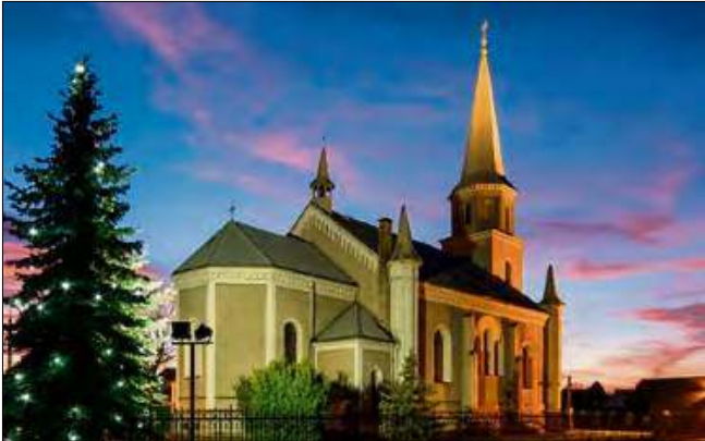
Elewacja kościoła parafialnego w Obrowcu wymaga pilnego remontu.
