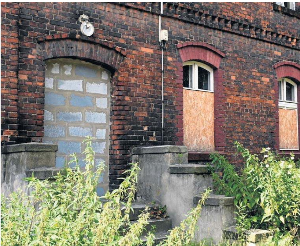
Opuszczone mieszkania w familoku przy ulicy Przemysłowej.
