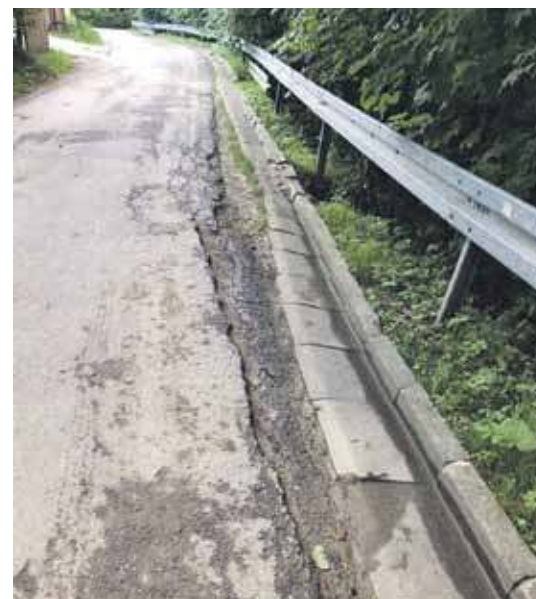
Zniszczony asfalt na ul. Gładkie.
