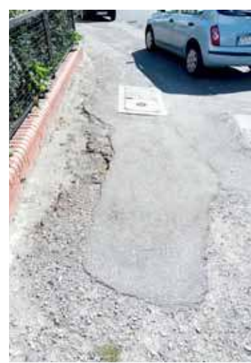
Ulica Plac Majdanek i asfaltowy chodnik, który na całej swojej długości jest mocno zniszczony
