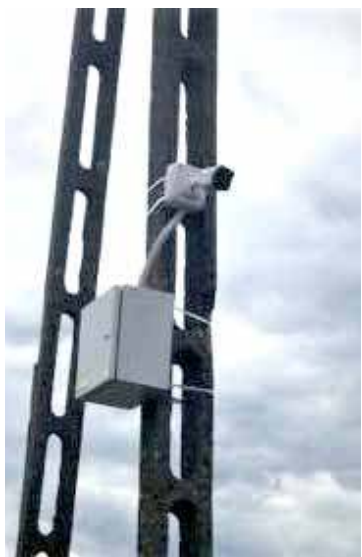
Rejestrator Generalnego Pomiaru Ruchu w Grabowie
