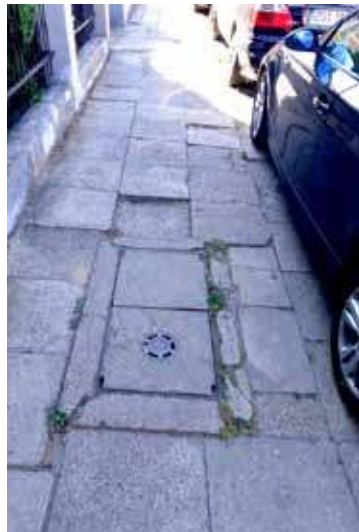
Po drugiej stronie ulicy Obrońców Westerplatte chodnik jest zbudowany z płyt betonowych, które również są mocno wysłużone
