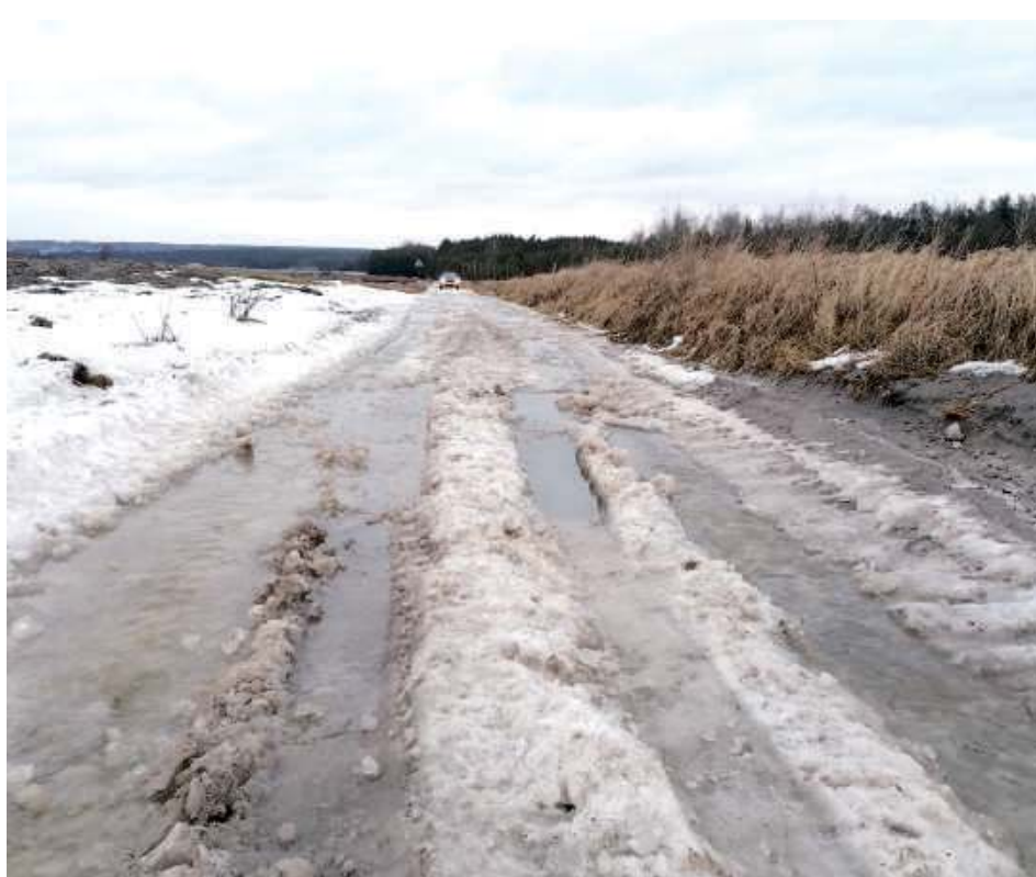
Gruntowy odcinek drogi z Kolonii Borów do Grąd jest trudno przejezdny. Byliśmy tam, gdy zaczął topnieć śnieg. Droga zamieniała się w bajoro
