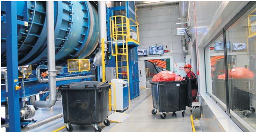
Instalacja Termicznego Przekształcania Odpadów Medycznych spółki Emka w Redzikowie działa od października 2024 roku
