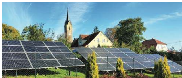
Pracę rozpoczęły już panele fotowoltaiczne oraz nowoczesna pompa ciepła
