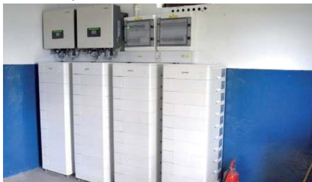
Energia pozyskana z instalacji fotowoltaicznej jest odkładana w specjalnych magazynach
