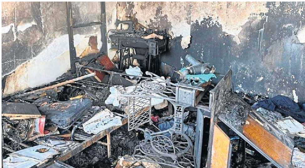
Wnętrze mieszkania spłonęło doszczętnie. Zostały gołe ściany i metalowe elementy, których ogień nie był w stanie strawić...
