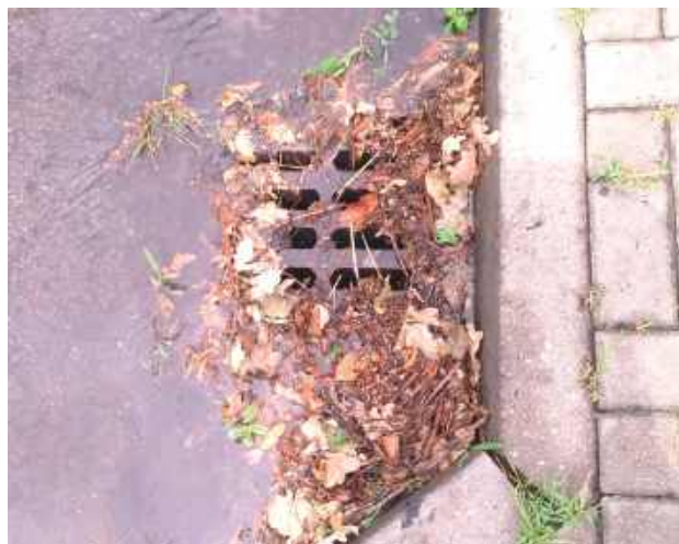
Na ulicy Kąpielowej - jak sama nazwa wskazuje - kratka ściekowa nie może być oczyszczona...
