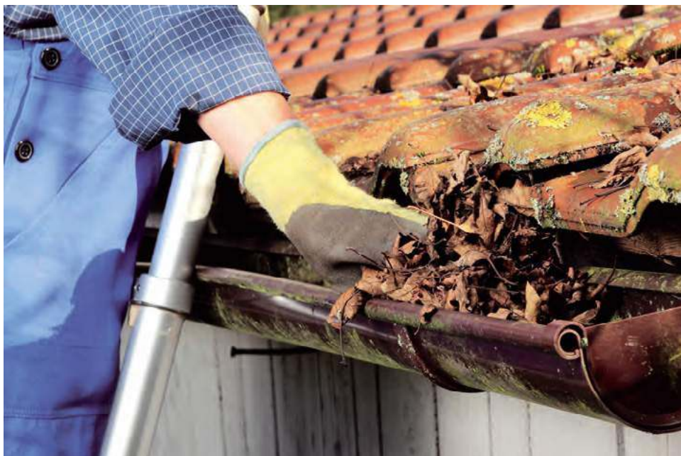
🔧 Z rynien trzeba regularnie usuwać nieczystości – liście, gałęzie, szyszki itp. – które blokują odpływ deszczówki. GALECO
