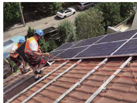
Instalację PV można łatwo wykonać także w już istniejących budynkach. A. PAPLIŃSKI
