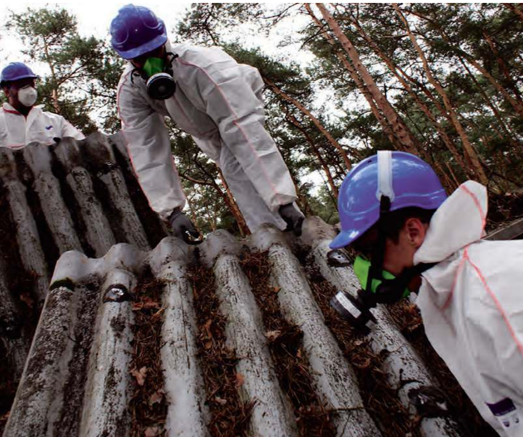
❗ Płyty azbestowe nie stanowią zagrożenia dopóki nie są uszkodzone. RENOVO
