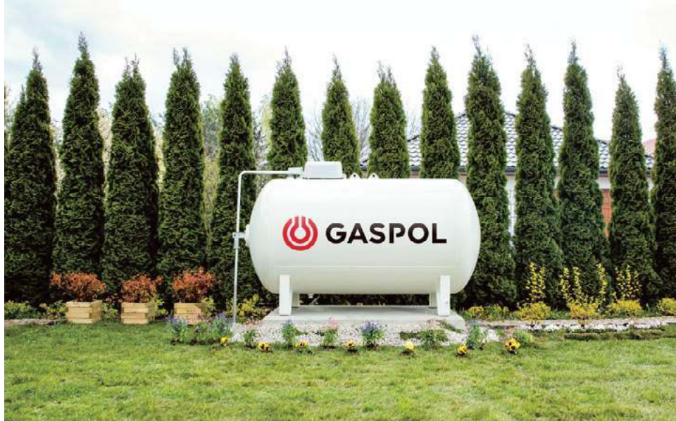
🔥 Gaz ze zbiornika, węgiel czy może pompa ciepła? To dostępność mediów determinuje rodzaj instalacji w domu. GASPOL
