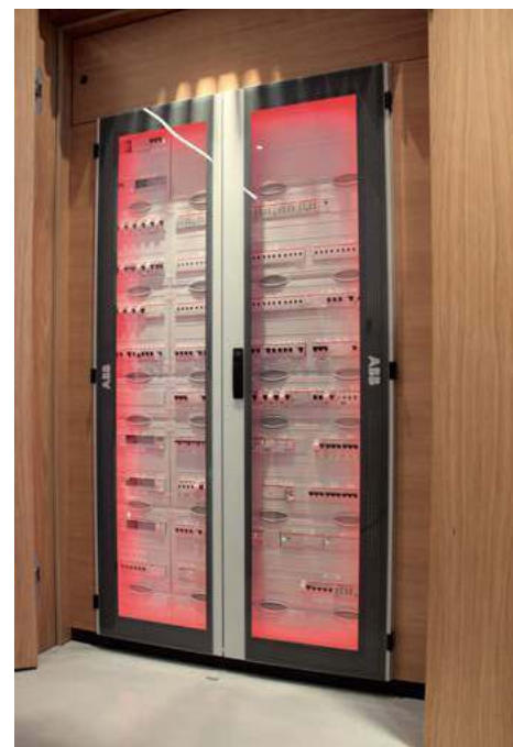
🔌 Szafa rozdzielcza – tu zbiega się okablowanie wszystkich instalacji (w tym przypadku dość rozbudowanych), w które wyposażono inteligentny dom. J. WERNER
