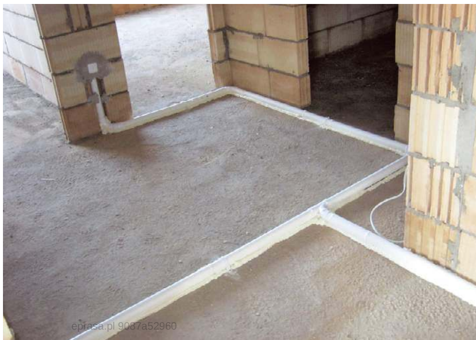
➤ Rurociąg składa się z rur PVC o niewielkiej średnicy (50–55 mm). TOPVAC
