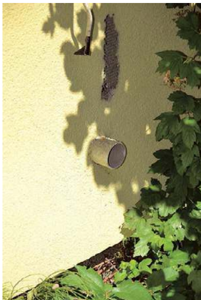
Wylot wyrzutni powietrza przez ścianę w garażu. ARCHIWUM BD
