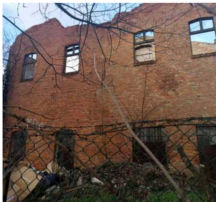
Widok na niszczący budynek od strony Parku 3 Maja
