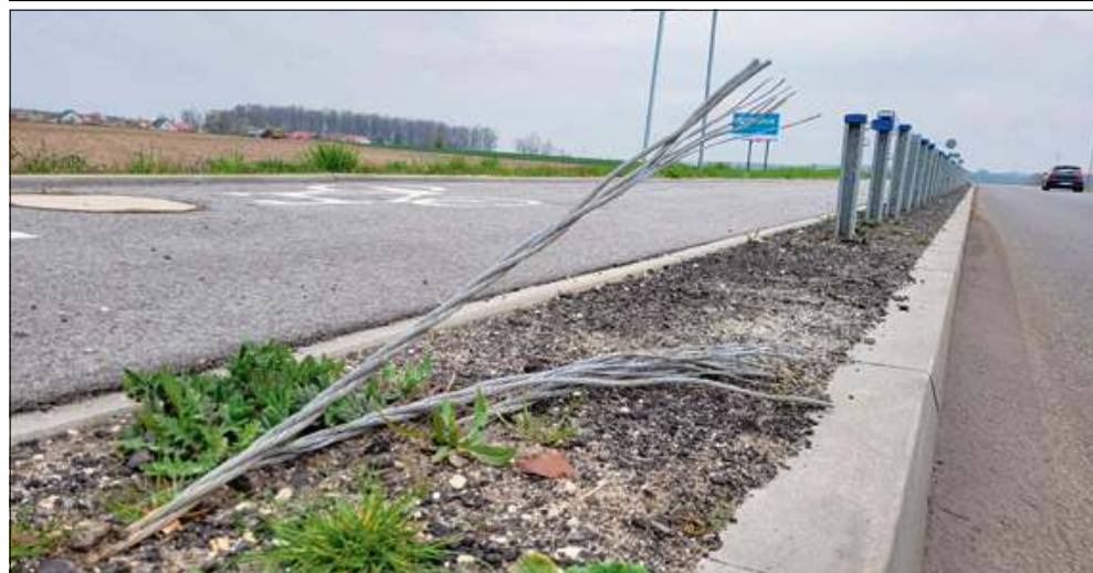
W Mosznej skradziono ok. 1400 metrów barier linowych.
