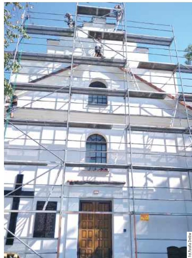
Dzięki tej inwestycji kościół w Drelowie zostanie zabezpieczony i odnowiony, a jego walory historyczne i estetyczne zachowane dla przyszłych pokoleń
