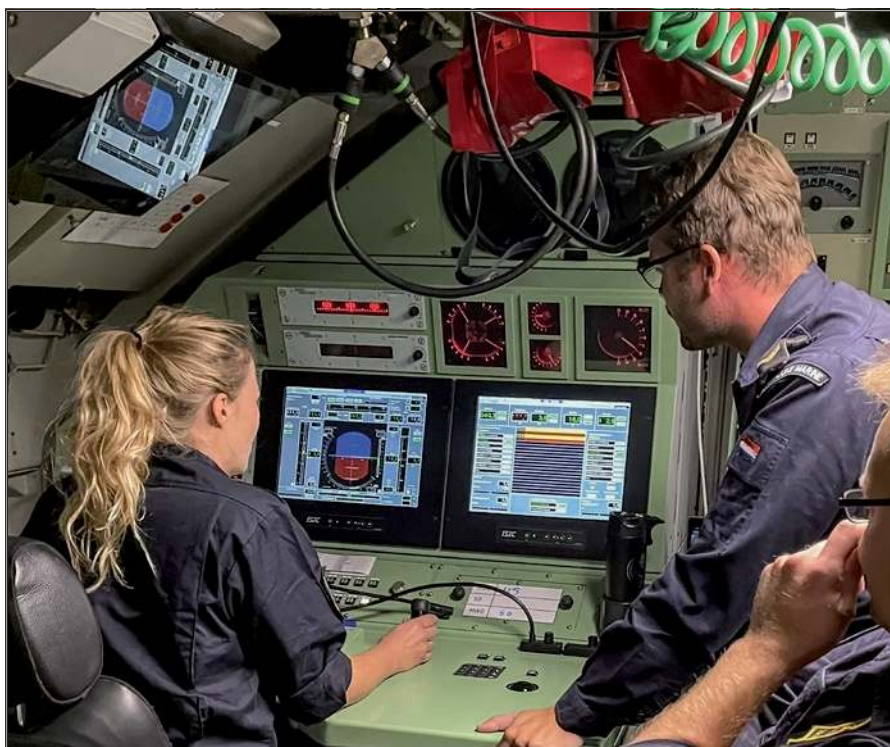
Zmodernizowane stanowisko manewrowe na okręcie podwodnym typu Walrus/Zeeleeuw.
