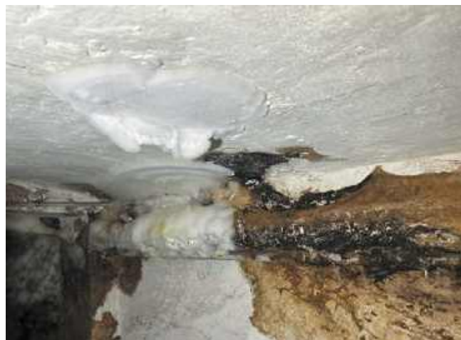
FOT. Grzybnia stroczka domowego na ścianach i stropach ceramicznych; fot.: autor
