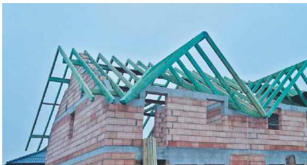
FOT. Typowy obraz z polskiej budowy, na której zastosowano „impregnowane” drewno. Intensywny kolor nie jest potwierdzeniem jakiegokolwiek wpływu impregnacji na podniesienie właściwości użytkowych konstrukcji drewnianej zarówno w zakresie klasy reakcji na ogień, jak i korozji biologicznej; fot.: E.J. Kotwica
