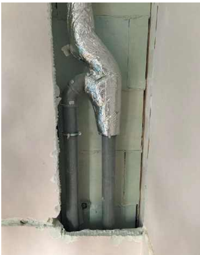
FOT. 6 Zdjęcie przedstawiające nietypowe rozwiązanie – przesunięcie pionu rury kanalizacyjnej na wysokości mieszkania w trakcie instalacji dodatkowej izolacji; fot.: Falcon Acoustics
