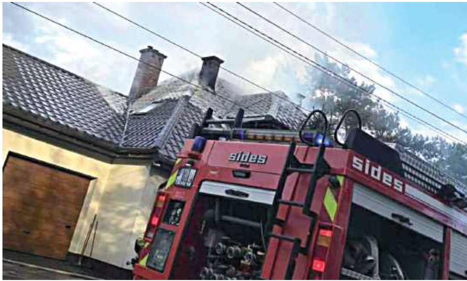
Maciej i Ewa w jednej chwili stracili poczucie bezpieczeństwa. Ogień strawił całe piętro budynku, a pozostała część domu wymaga dziś generalnego remontu. Najpilniejszą potrzebą jest odbudowa dachu, zarówno jego konstrukcji, jak i pokrycia. Możecie pomóc!
