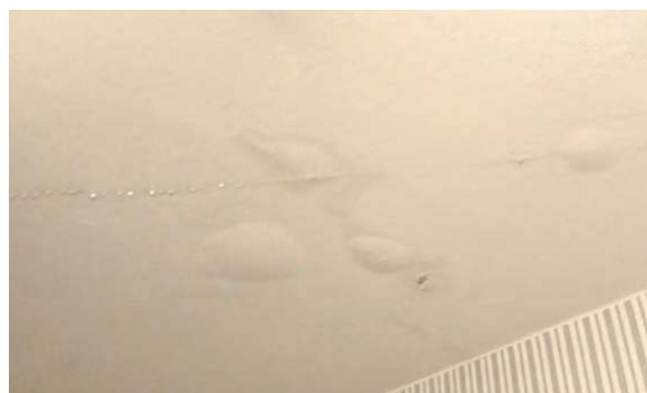
Szkody na suficie bardzo szybko się ujawniły.
