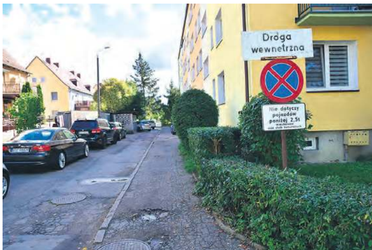
Mieszkańcy bloku przy ul. Piastowskiej 2/4/6 nie mogą liczyć na kompleksową poprawę stanu chodnika. Ale dziury mają być załatwione „w najbliższym czasie”.
