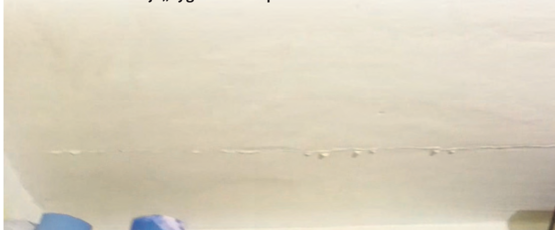
Jeden z przecieków, pod którym akurat znajdują się książki.
