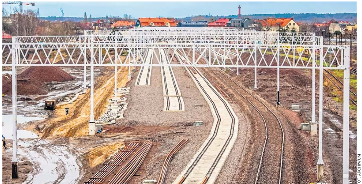
Zakończenie prac planowane jest na grudzień. Wartość wszystkich robót wynosi ponad 32 mln zł netto.
