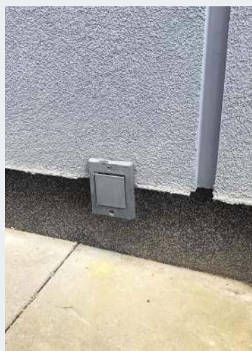
➋ Przewód wyrzutni wyprowadzono przez mur budynku.
