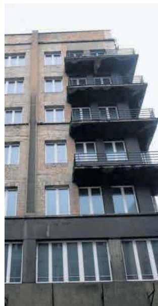
Stara elewacja... No tak, remont był pilny
