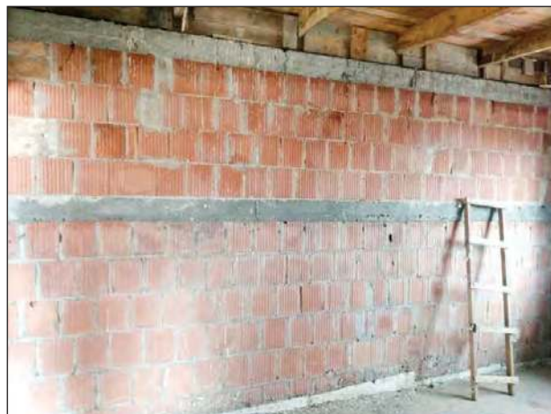
■ Według słów Jarosława Michalika, nadbudował on w klatce schodowej (nie czekając na decyzję starostwa) cztery rzędy cegieł w górę z jednej strony. Na zdjęciu widać je od końca drabiny w górę
