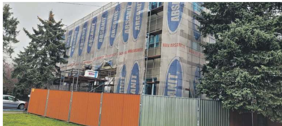
Dawna siedziba Usług Komunalnych z adresem Rynek 18 (przez starszych mieszkańców miasta znana jako Szwajgierówka od nazwiska byłych żydowskich właścicieli budynku dawnej szkoły, która w tym miejscu funkcjonowała), z zewnątrz doczekała się liftingu. Przetargu na termomodernizację nie udało się co prawda gminie rozstrzygnąć, ale prace zlecone zostały w innym trybie.
