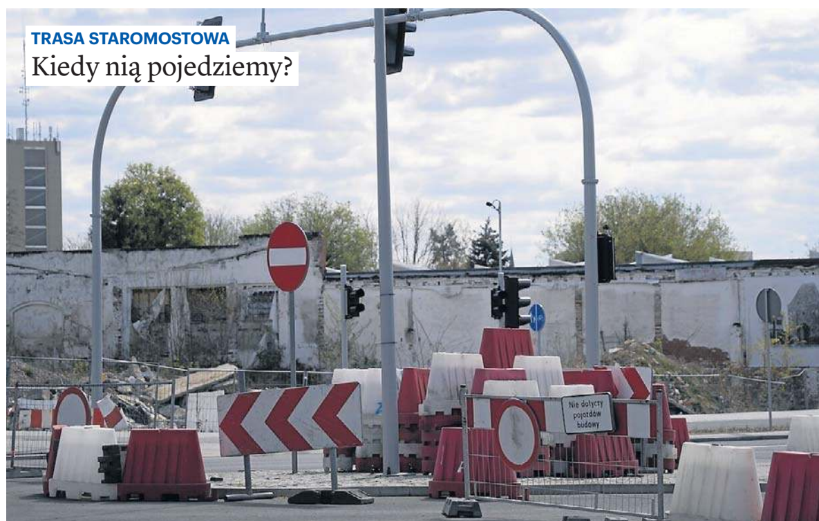
Tak wczoraj wyglądał odcinek trasy staromostowej w centrum Torunia. Na dokończenie jego budowy potrzeba jeszcze kilku dni. Zostanie udostępniony prawdopodobnie w pierwszej połowie maja - str. 4
