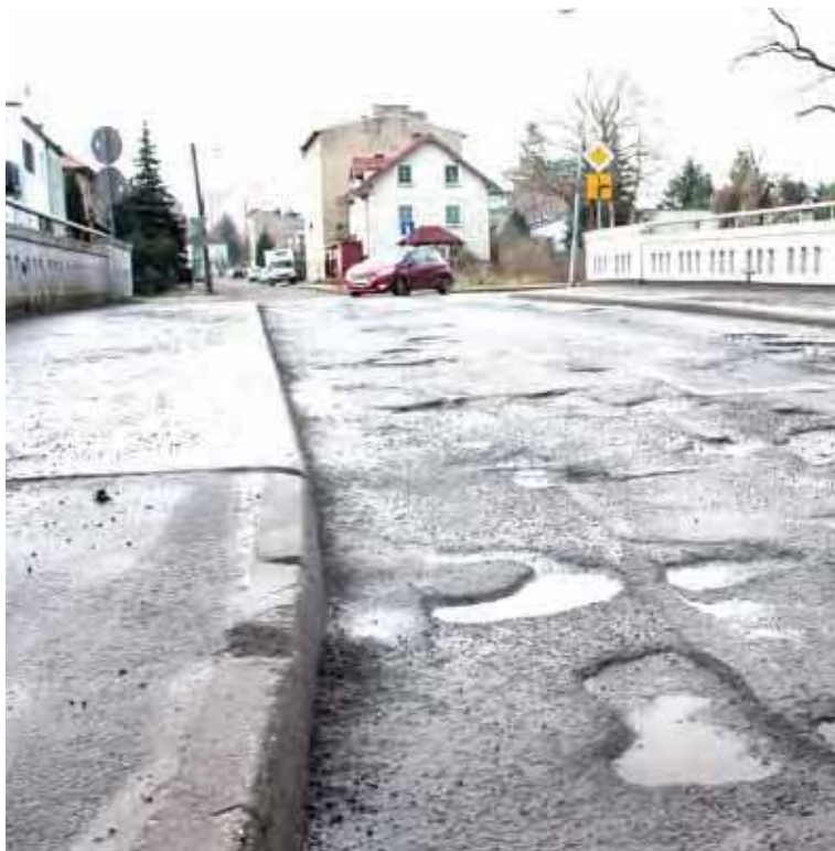
Nawierzchnia drogi biegnącej przez most na ul. Młyńskiej przypomina ser szwajcarski.
