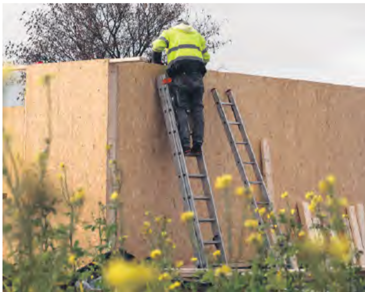
Tak zwane płyty „sip”, z których składa się każda ze ścian, strop czy połacie dachowe, ważą po kilkadziesiąt kilogramów. Doprowadzenie do stanu surowego zamkniętego 120-metrowego budynku zajmuje ok. 6 tygodni.
