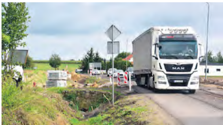
Kierowcy podróżujący przez Gostycyn muszą uzbroić się w cierpliwość. W związku z realizowaną inwestycją ruch od strony Tucholi odbywa się wahadłowo.
