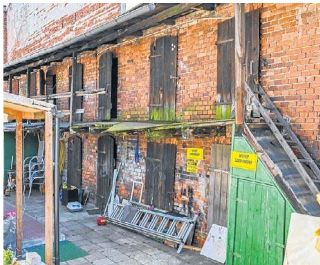
PINB stwierdza, że budynek jest w złym stanie technicznym, ale nie jest „katastrofą budowlaną”
