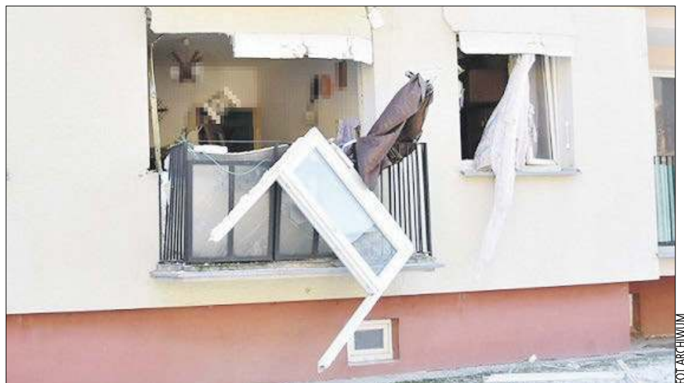
Z ustaleń inspektora nadzoru budowlanego wynika, że wybuch nie spowodował naruszenia konstrukcji budynku
