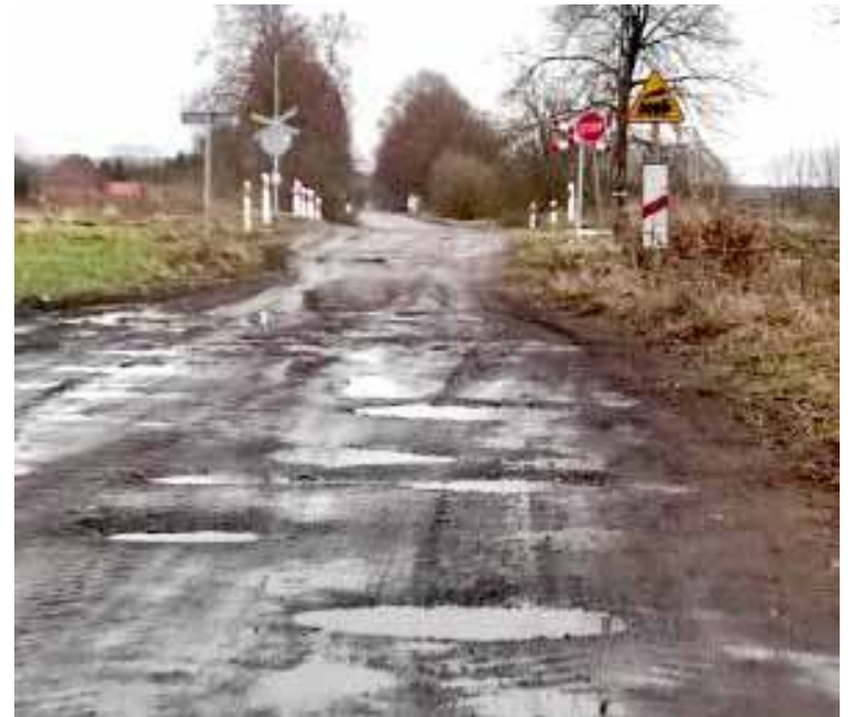
Fatalny stan drogi zauważalny jest już przy samym przejeździe
