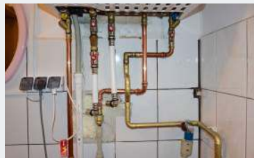
❷ Orurowanie kotła i rura PVC, odprowadzająca kondensat do kanalizacji.
