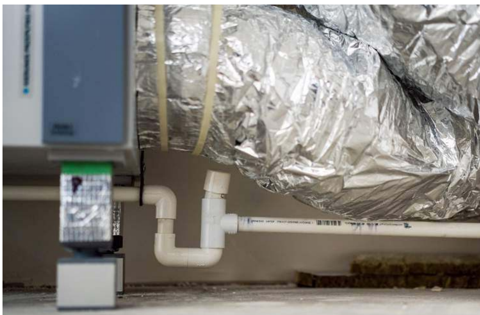
➔ Odpływ skroplin z centrali. PRO-VENT
