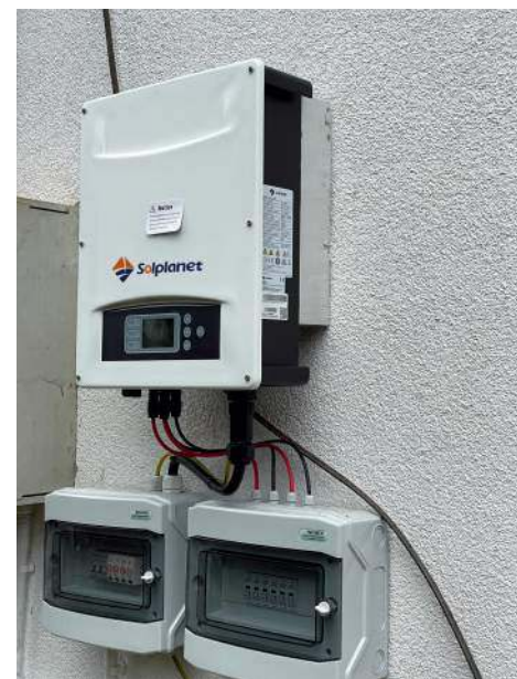
➋ Dobrej jakości komponenty instalacji to gwarancja jej długoletniej, bezawaryjnej pracy. SOLPLANET
