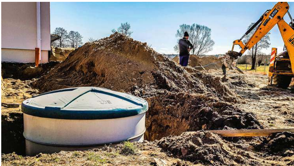
❗ Decydując się na własną oczyszczalnię, warto zapytać w gminie czy nie przydzieli dotacji na budowę przydomowych oczyszczalni ścieków. EKO HOUSE
