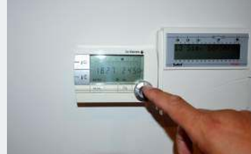
❸ Regulator pokojowy zainstalowano w korytarzu w oddzielonej strefie z trzema sypialniami.
