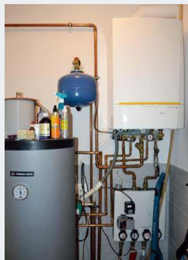
📍 Urządzenia grzewcze umieszczono w kotłowni o powierzchni 15 m 2 .
