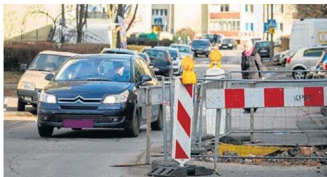
Dziura w jezdni utrudnia ruch samochodów i zmusza przechodniów do przejścia na drugą stronę ulicy
