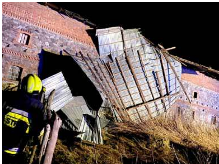
W miejscowości Wielen wiatr uszkodził dach na budynku gospodarczym. Foto. OSP. Chociwel
