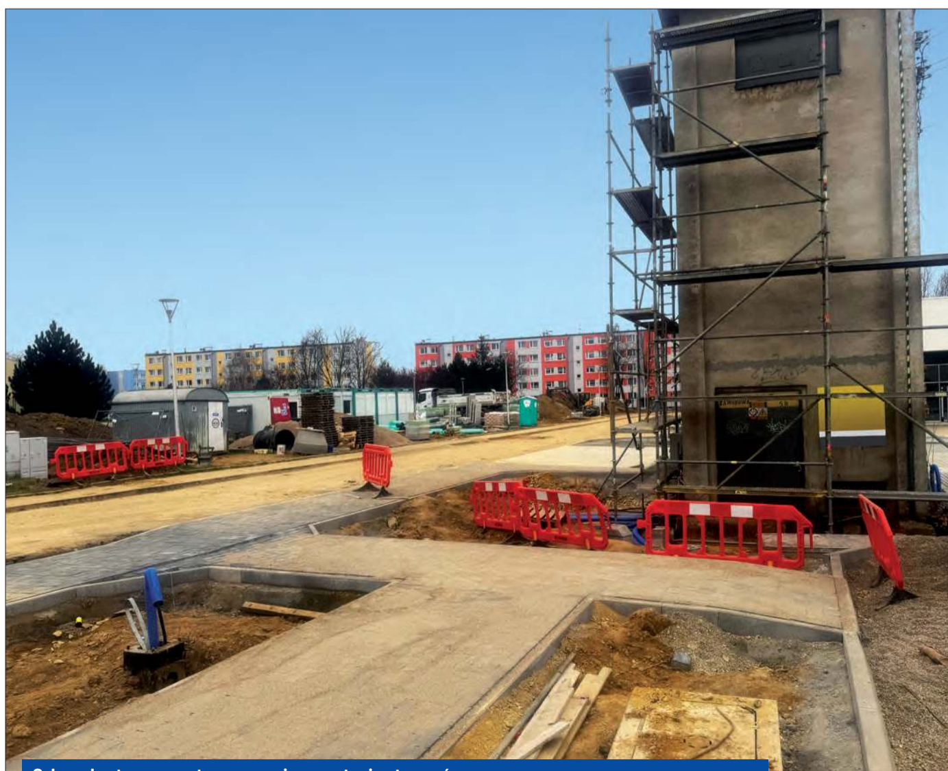
Szkaradny transformator nareszcie przestanie straszyć
