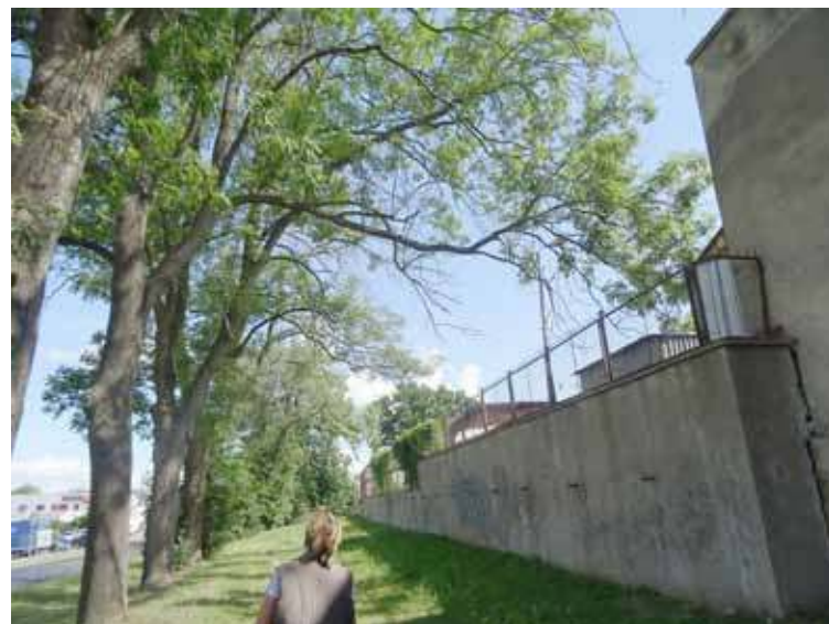
Sucho gałęzie nad chodnikiem i budynkiem
